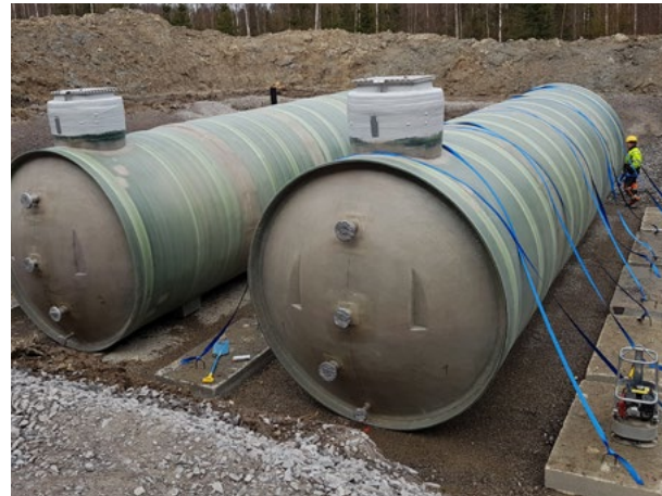
Välisäiliöt ovat tilavuudeltaan molemmat 75 000 litraa eli yhteensä niissä on omakotitalon vuosikulutuksen verran vettä.
